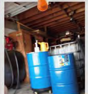
Almacenamiento de gasolina cerca de viviendas de trabajadores
